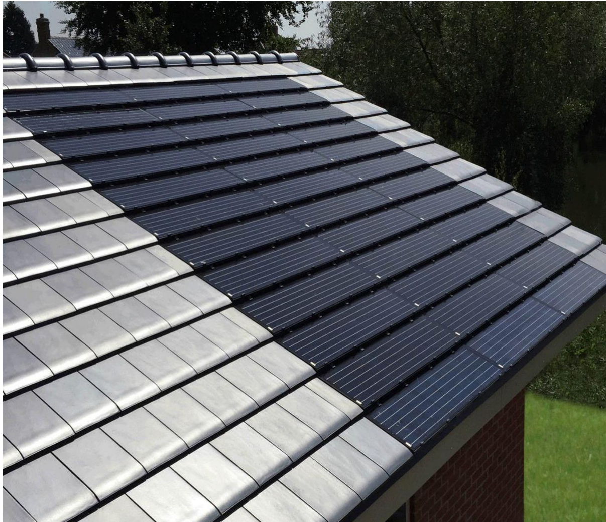
Utilisation des tuiles photovoltaïques d'IMERYS Toiture – 36 tuiles produisant 1080 Xc.
