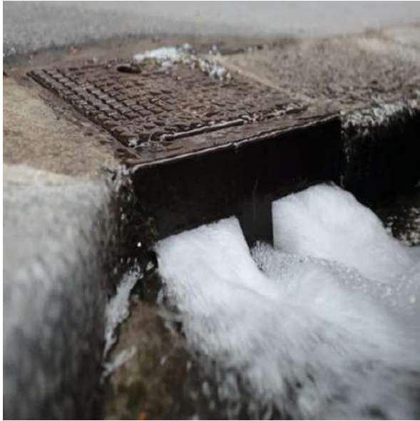
Bouche de lavage
