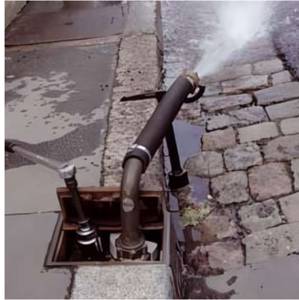
Bouche de remplissage
